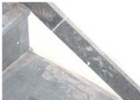
Foto 16. Detalj skiferfiser på trapp og sokkellist Et område manglet skifer og avslørte lim-som rent ned i fugen.
